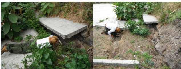
Fig. 7. Ensanchamiento de la grieta des pues de la actividad sísmica.
