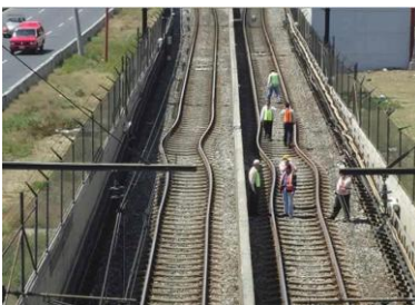
Fig. 6. Deformación de las vías del metro cerca de la estación Peñón Viejo.
